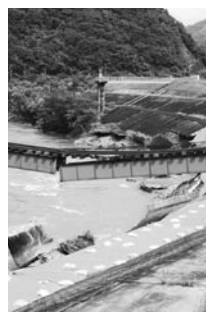
H25.8.24 豪雨災害で因原鉄橋落下
