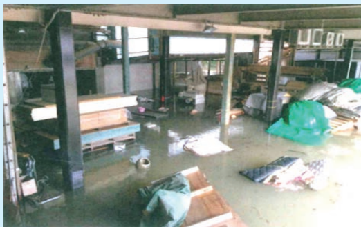
浸水した(有)創修工場(R2.7月豪雨災害)
